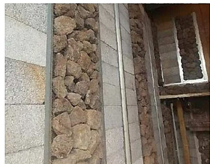
抗火石を引き詰めた木材乾燥システム
