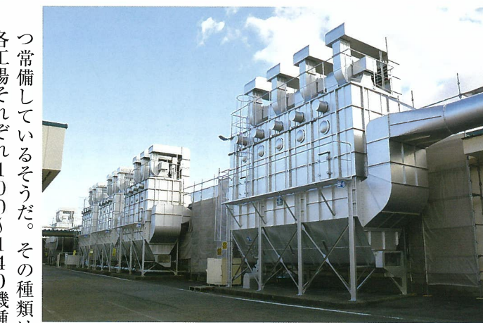
▲集塵機は井上電設製。集めた木屑はボイラーに直結して冷暖房や塗装の乾燥室の熱源に利用する
