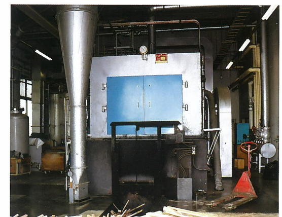
▲タカハシキカンのバイオマスボイラー
